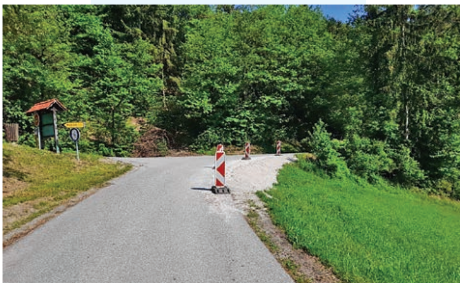
Zemeljski plaz na lokalni cesti v Loki pri Framu
